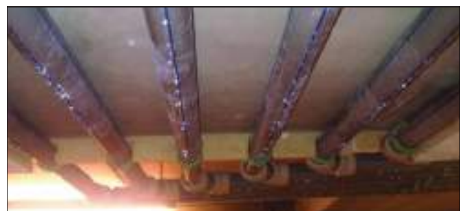
Ilustración 6.5 Condensación en tuberías de agua fría
