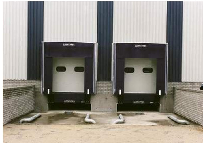
Figura 5.11. Muelles de carga. Fuente: www.puertas-garaje-guadapuerta.com
