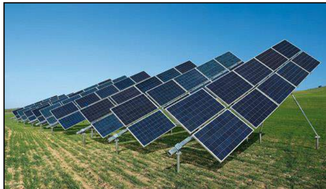
Ilustración 14. Sistema de seguimiento solar en un eje polar.
