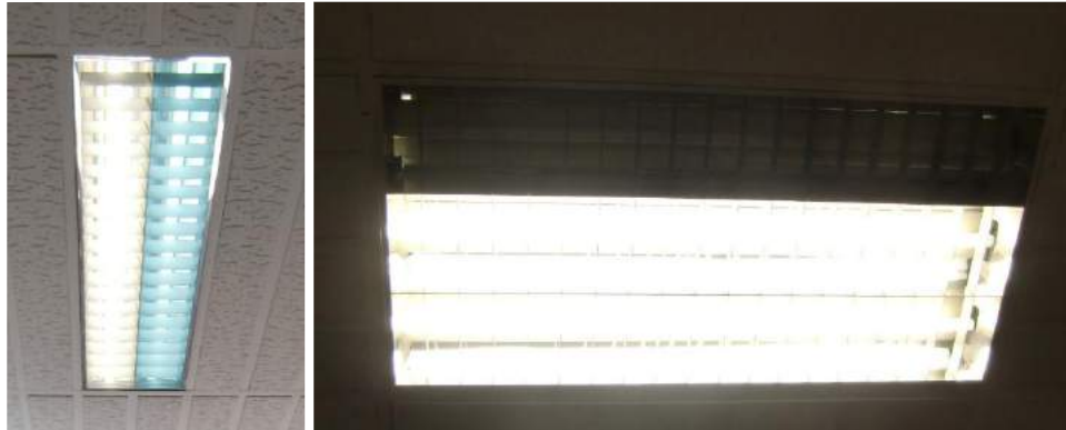
Figura 2.5 – Ejemplo de mala iluminación
