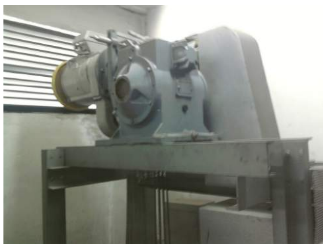
Ilustración 4: Detalle de motor de ascensor eléctrico
