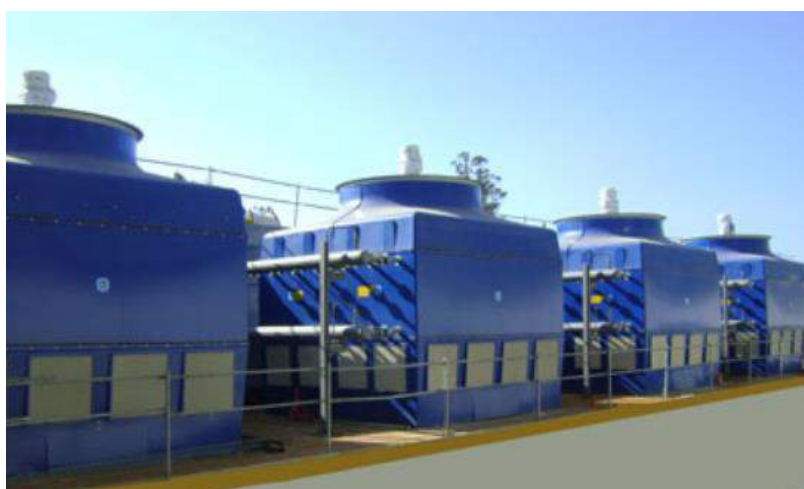
Figura 44: Torres de refrigeración industrial
