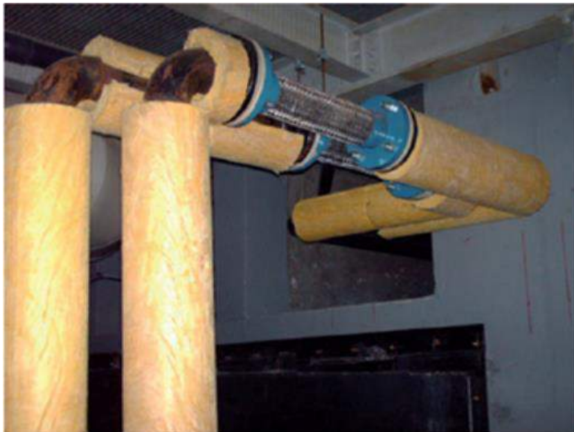
Figura 22: Aislamiento de tuberías de una red de vapor
