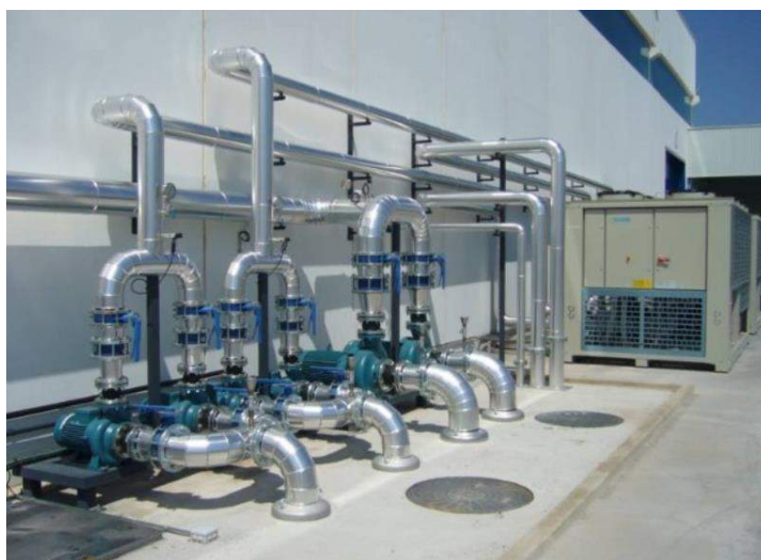
Figura 39: Tuberías de transporte de agua de refrigeración por el exterior de una planta química
