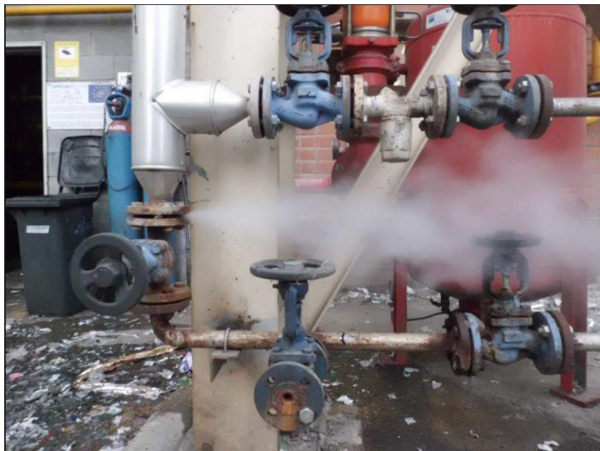
Figura 24: Fugas de vapor en red de tuberías
