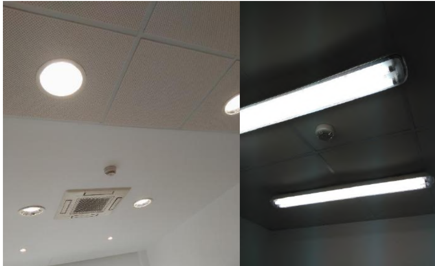
Figura 15. Principales tipos de luminarias instaladas en el centro
