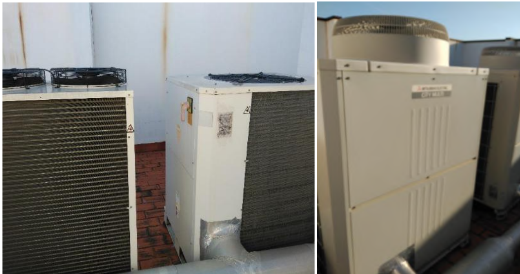
Figura 18. Imágenes de los equipos de climatización
