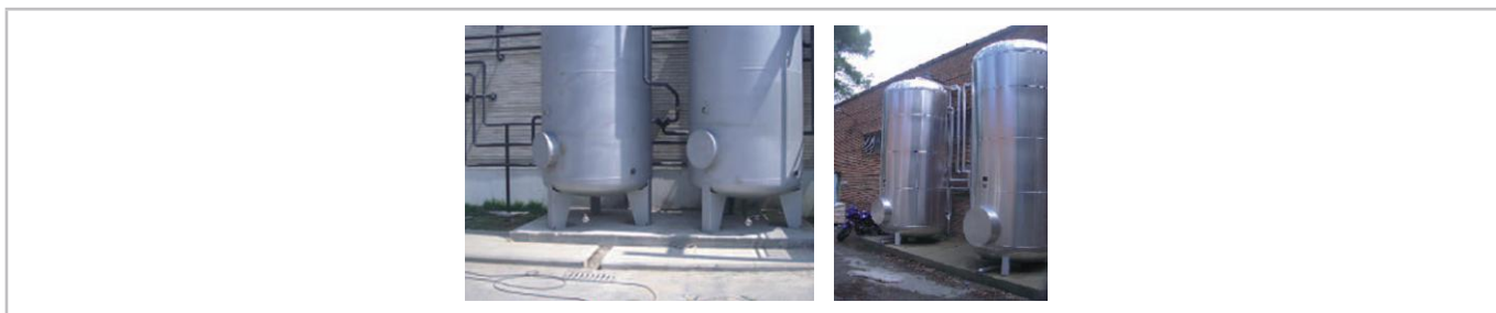
FIGURA 8-10 EJEMPLOS DE ACUMULADORES SITUADOS EN EL EXTERIOR DE EDIFICIOS
