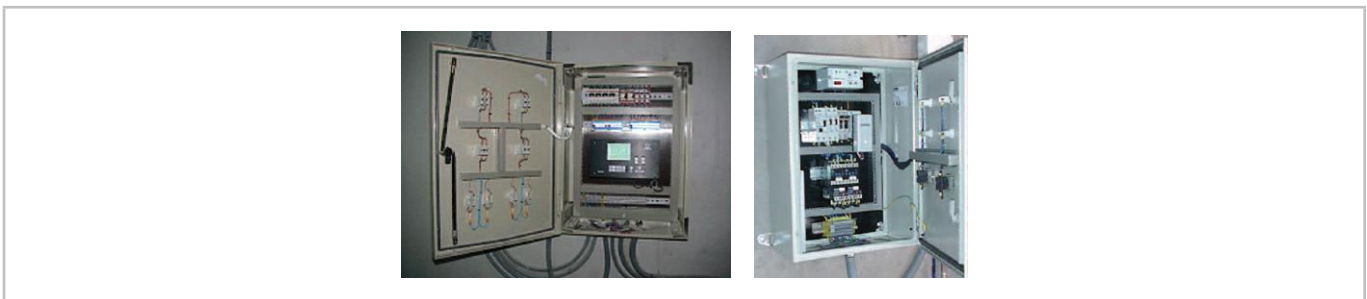
FIGURA 4-28 CUADROS ELÉCTRICOS CON LOS EQUIPOS DE CONTROL INCORPORADOS
